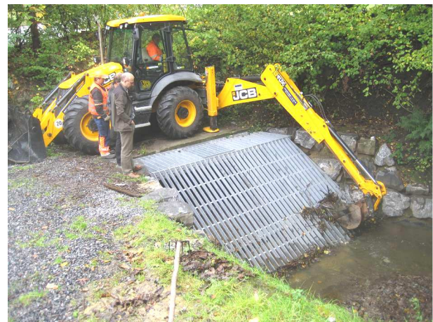
Foto 86: Neues Durchlassgitter Frielingsen
